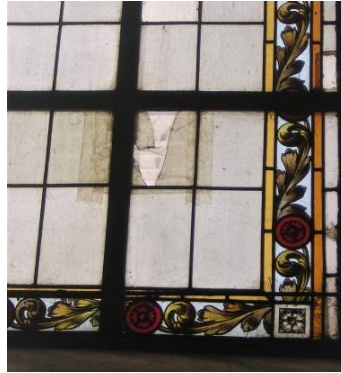
Gesprungene, provisorisch gesicherte Verglasung
