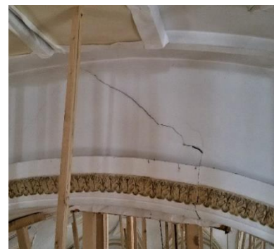
Chorbogen mit durch Schubkräfte verursachtem Riss
