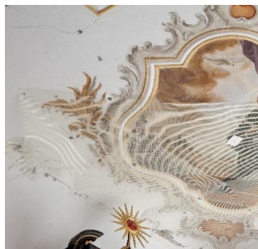
Mit Verschraubung und Netz notgesicherte Deckenzone
