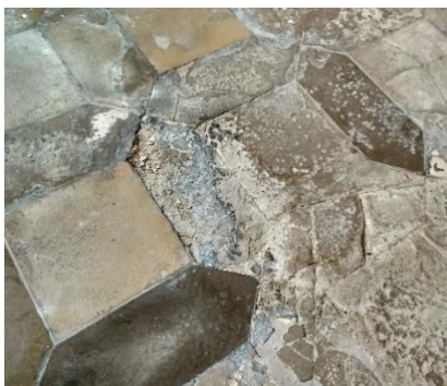
Bodenbelag aus Kalkstein mit stark angegriffener Oberfläche und losen Platten
