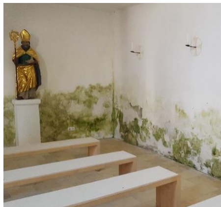
Algenbewuchs an den Wänden
